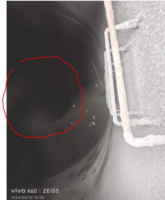
图 2 事故发生后 2 号炉渣库底部图片
